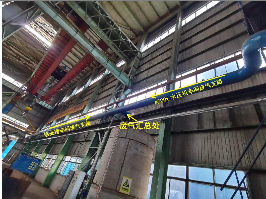
排气筒 P3 进口口图
