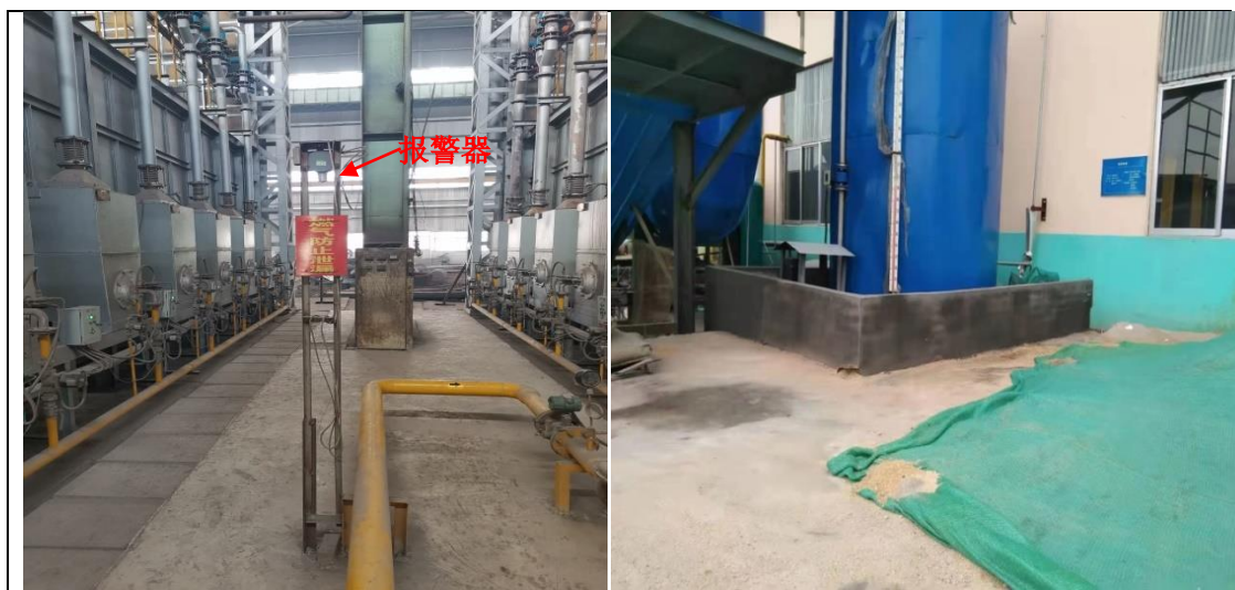
易燃易爆气体泄漏检测报警系统
